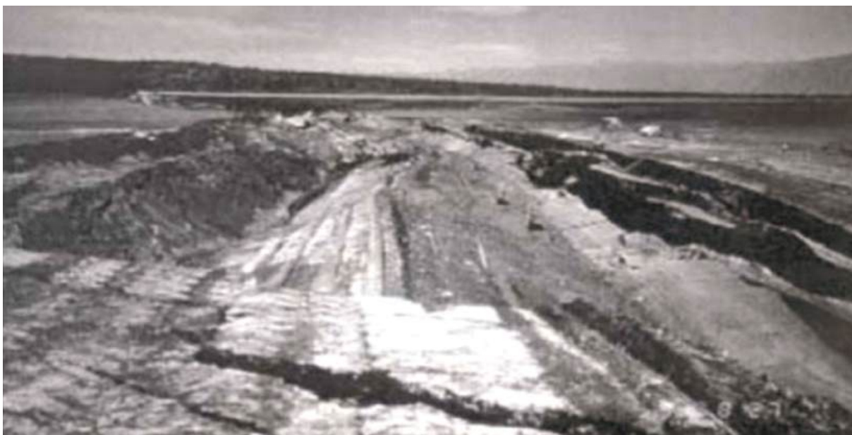
Figura 6 - Ruptura por liquefação da barragem de Sullivan (Davies et al. 2002, apud Freire Neto, 2009).
